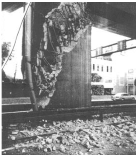
Obr. 10 Viadukt Hanshin po zemětřesení v Kobe roku 1995
